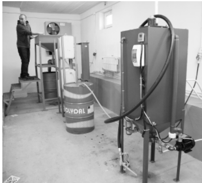
“Przydomowa” wytwórnia biodiesla z oleju rzepakowego. Problem z eksploatacją tego rodzaju instalacji nie leży w technice, ale w przepisach fiskalnych.
