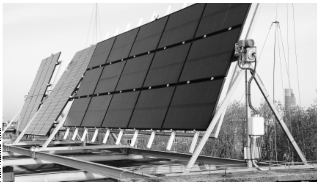
Panele fotowoltaiczne na dachu Politechniki Warszawskiej.
