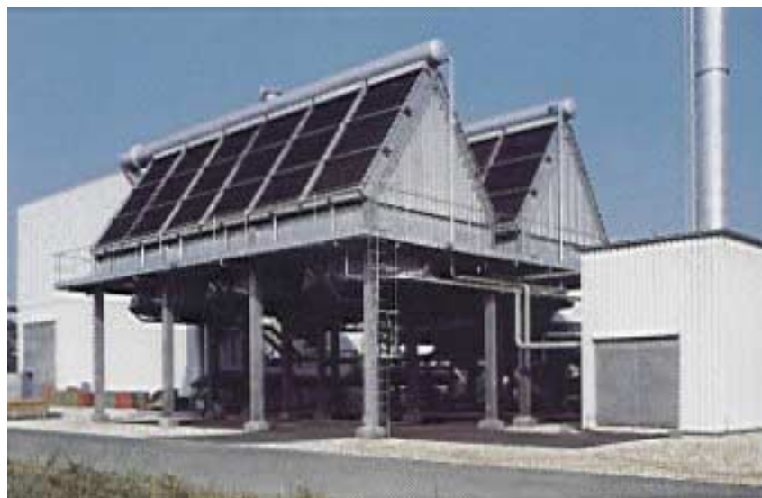
Rys. 2.15 Przykład skraplacza chłodzonego powietrzem do skraplania pary wylotowej z turbiny [tm111, BDAG, 1996]
